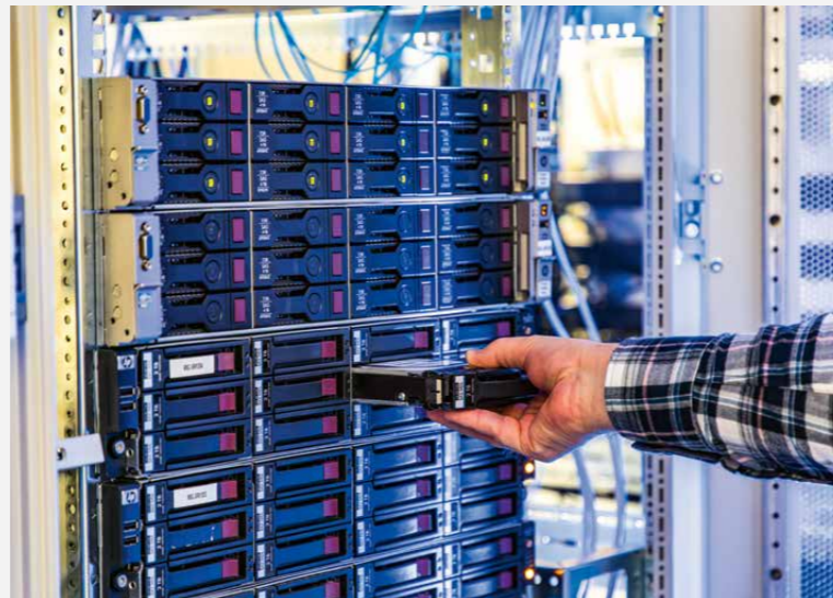
Serverraum des Landesarchivs in Coerde, Foto: J. Tack
