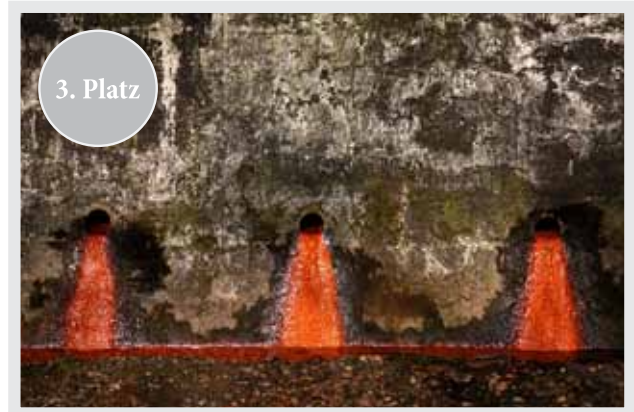
Entwässerungsrohre der Zeche Treue, Bochum Engelbert Wühl
