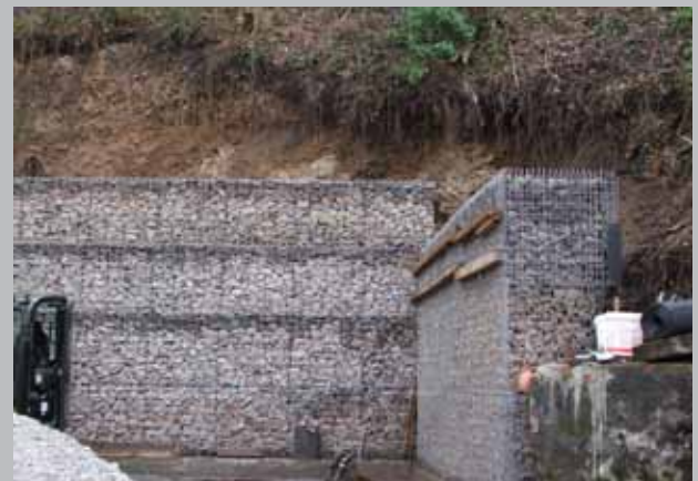
Aktueller Zustand: Aus Schutz vor Steinschlag wurde vor dem Stollenmundloch eine Gabione errichtet
