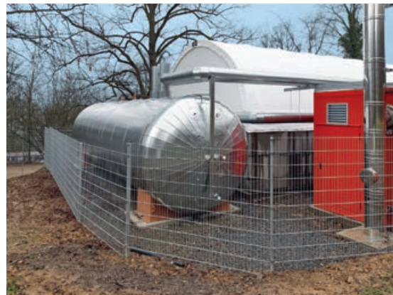
Innerhalb des Nahwärmenetzes grenzt der Pufferspeicher mit 50.000 Liter Volumen direkt an das Lager für die Holzschnitzel.
