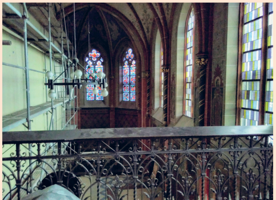
Noch sind die Fenster zur TaK-Seite ausgebaut. Wenn sie im März eingesetzt werden, geht die Sanierung in die Endphase.
