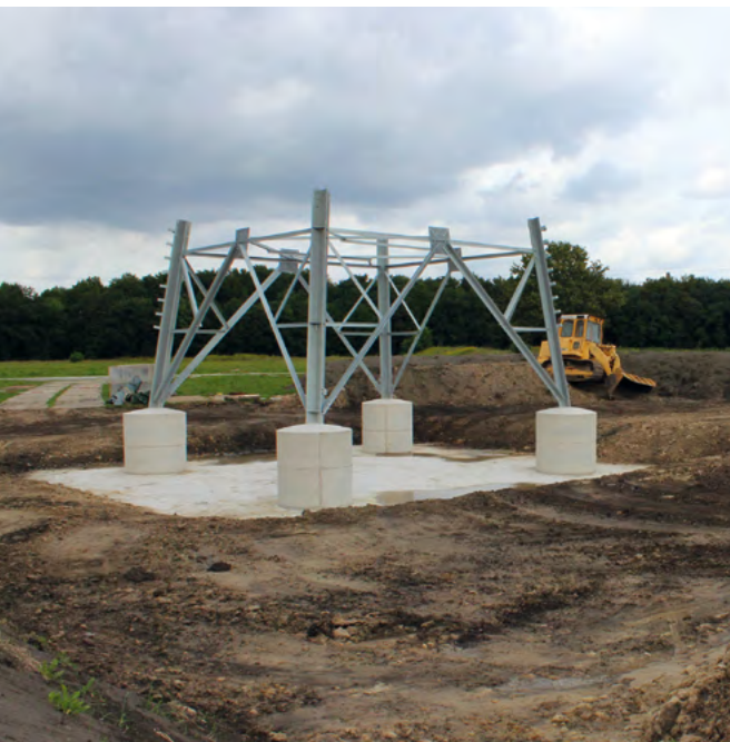
Der Bau von Freileitungsmasten führt zu erheblichen Eingriffen, oft auch mit Wasserhaltung (Bild: M. Stenzel).
