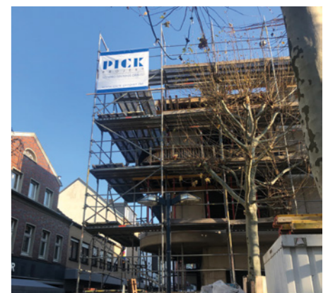
Die Strukturen des Gebäudes lassen sich so langsam durch die Gerüste erahnen. © Stefan Pick
