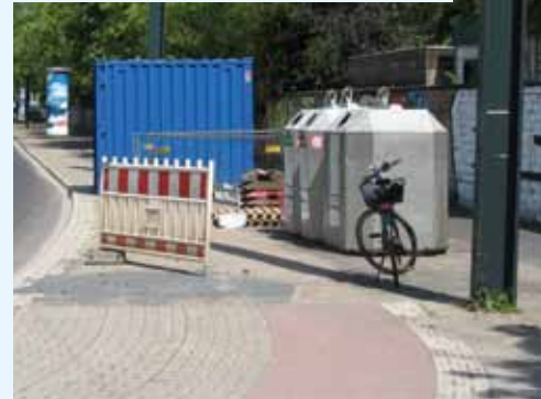
Baustelle Ulmenstr. Radweg führt in die Sperre ohne Umleitung
