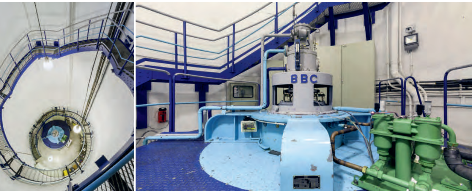
Das Listerkraftwerk (oben und rechts) wurde technisch angepasst und wird nun ebenfalls zur Spotvermarktung eingesetzt.
