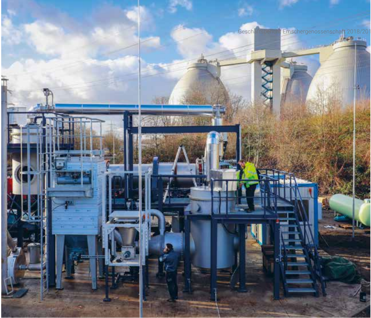
Mit der EuPhoRe-Anlage in Dinslaken – kurz vor der Inbetriebnahme – wird aus Klärschlamm Phosphor gewonnen.
