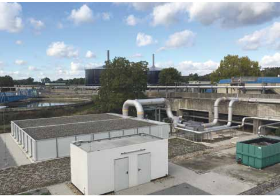
Neu errichtete Abluftbehandlung
