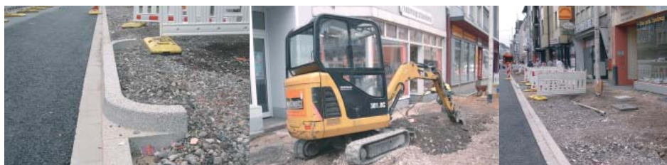
Die Rohre liegen inzwischen unter der Straße und die Bürgersteige mit Parkbuchten werden vorbereitet Foto: A. Bellmann
