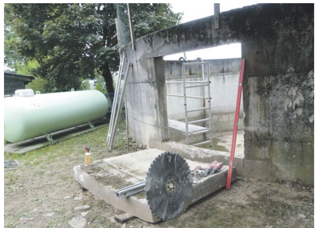
Der ehemalige Gülletank des Tierheims während der Sanierung. Es fehlt noch ein Dach.
