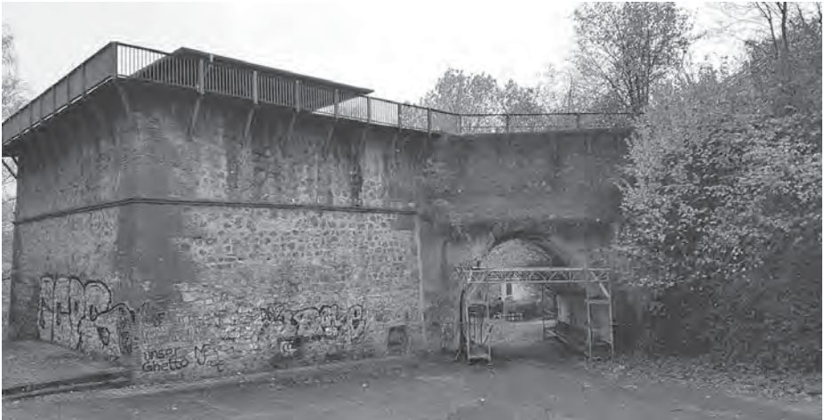
Der Kalktrichterofen am Eskesberg: Seit Jahren sichert ein Gerüst den schadhaften Viaduktbogen.
