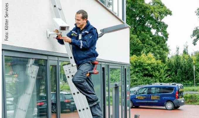
Moderne Videotechnik gewährleistet einen wachsamem Blick über das Firmengelände.
