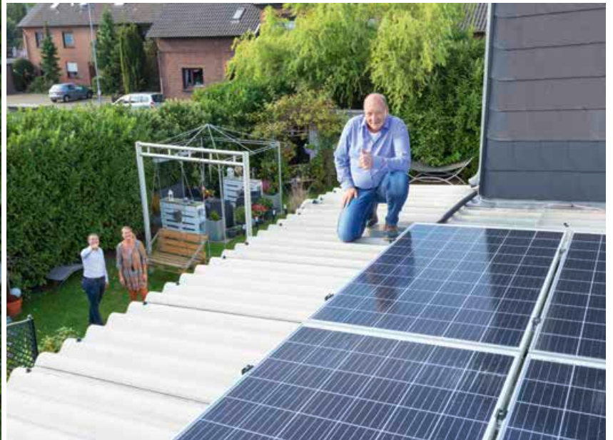
Bei Familie Damschen wurde die Solaranlage auf dem Dach der Garage installiert. Hier haben die Module die optimale Ausrichtung, um viel Ökostrom zu liefern.
