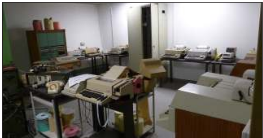
„High Tech“ der siebziger Jahre im Fernmeldezentrum des Regierungsbunkers an der Ahr.
