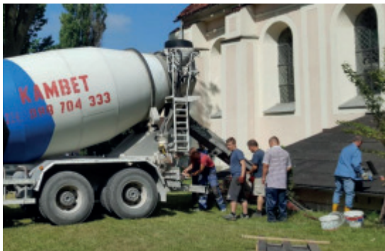
Ehrenamtliche Erneuerung der Heizungsanlage in der Kirche von Szczytno Foto: A. Borski
