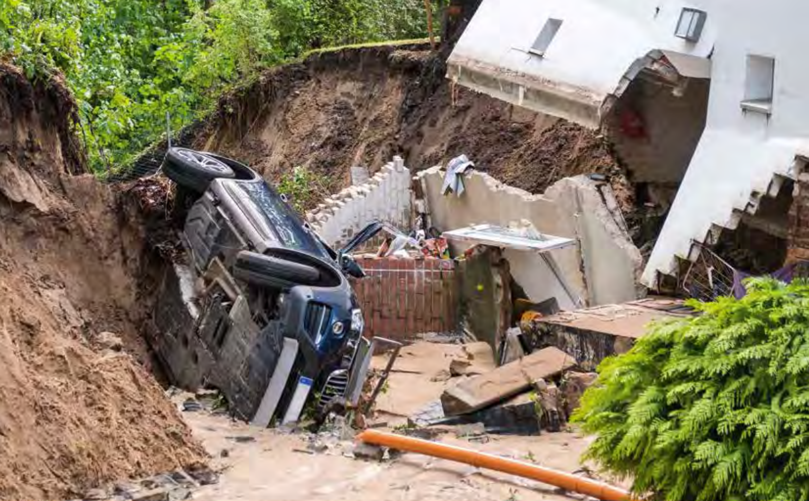
Ein Luftmassenwechsel von warm nach kalt führte am 10. Mai heftige Niederschläge mit sich. Nach Unterspülung mussten die Bewohner dieses Hauses in Hamburg-Lohbrügge evakuiert werden. (Quelle: picture alliance / Daniel Bockwoldt / dpa)
