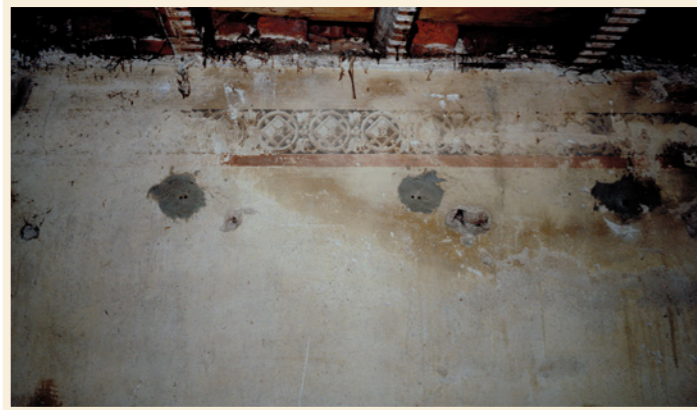
"Abschlussband" im oberen Synagogenraum vor der Sanierung. (c) LVR-Amt für Denkmalpflege im Rheinland, Horst Hahn
