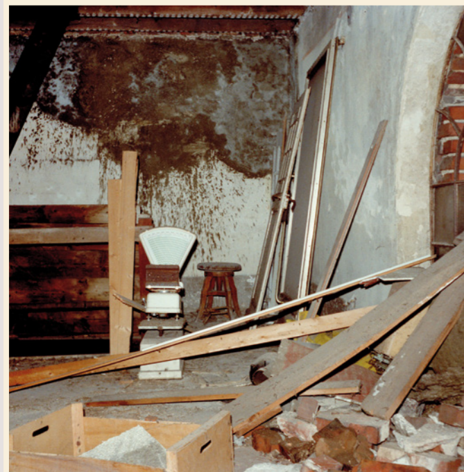
Das Gebäude befand sich in keinem guten Zustand. © LVR-Amt für Denkmalpflege im Rheinland, Horst Hahn
