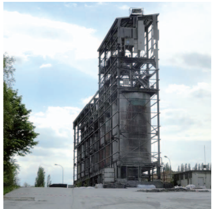
Die Siebanlage sollte eigentlich verschrottet werden.
