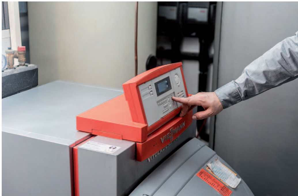
Moderne Brennwertheizungen sorgen für erhebliche Treibhausgas-minderungen.
