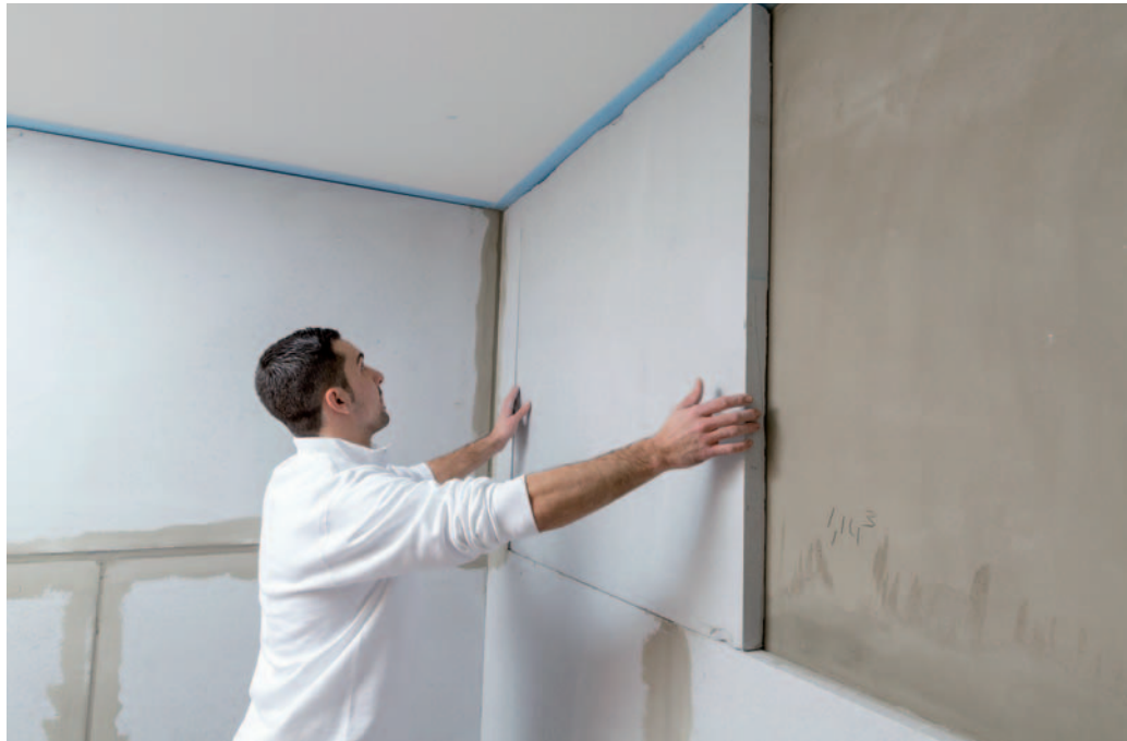
Gegen Kondensatprobleme helfen Klimaplatten.
