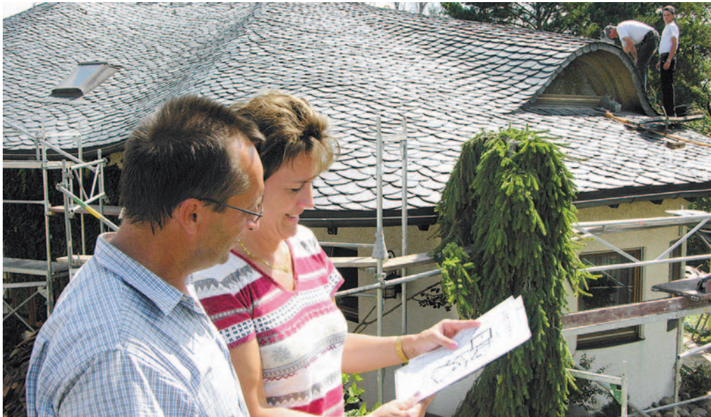
Die regelmäßige Wartung des Daches inklusive etwaiger Reparaturen sollte ganz selbstverständlich sein.
