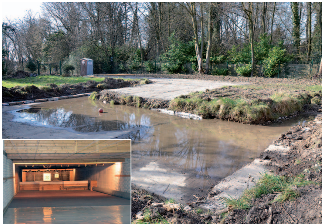
Umbaumaßnahmen für die Sicherheit: Hier entsteht ein zweiter Rettungsweg (mit Aufbau) zur unteren Schießhalle (kleiner Bildausschnitt).
