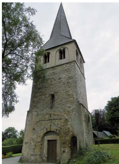
Der Nikolausturm vor der Sanierung. An der Außenwand musste eine Erdaufschüttung abgetragen werden. Foto: Maguire
