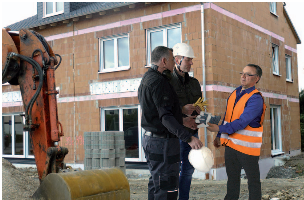
Private Bauherren sollten sich zudem in Sachen Arbeitsschutz umfassend durch die BG BAU beraten lassen.
