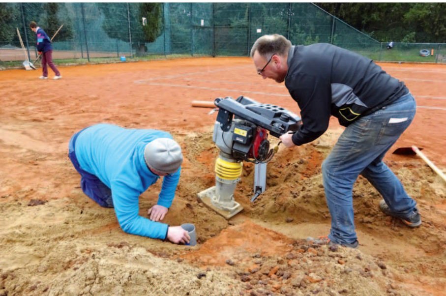
Auch so eine Sprinkleranlage ist beim Tennis nicht unwichtig. Foto: TC Blau-Weiß Monheim
