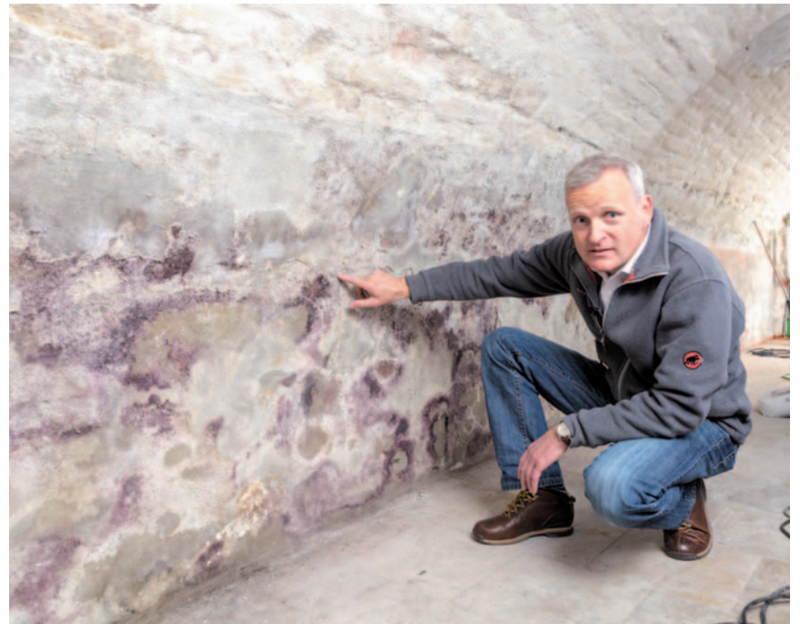
Kein Einzelfall: Schimmelpilzbefall im Keller.
