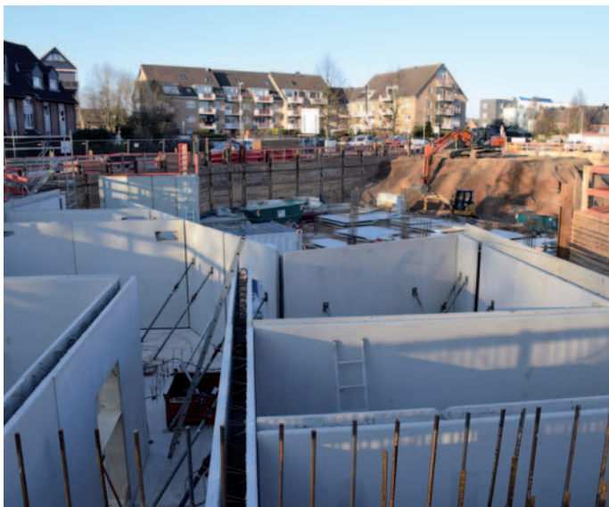
In der Baugrube sind bereits die Umriss des Kellers zu erkennen. Im vorderen Bereich ist Platz für Technik, im hinteren Bereich gibt es eine kleine Tiefgarage.
