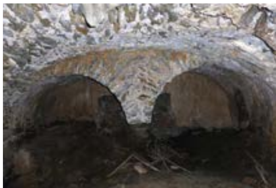
Blick in die Radkammer (carcabà) der Mühle von La Selva da Mar.
