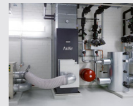
Technische Anlagen zu betreiben und zu unterhalten kostet Geld. Im Schnitt verursachen Gebäude in der Nutzungsphase mehr Geld als beim Bau. Mit der systematischen Erfassung von Erfahrungswerten im BIN-Tool können präzise Nutzungskostenvorhersagen für neue Gebäude gemacht werden.
