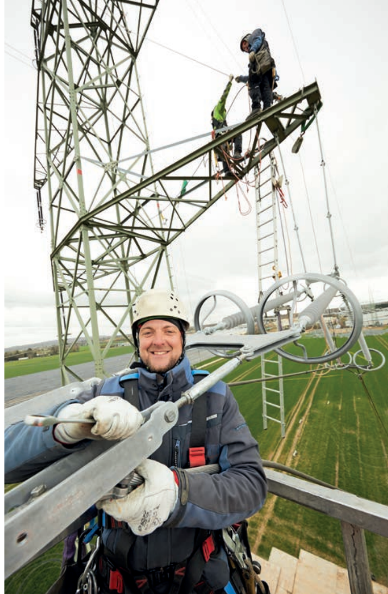
Der NEP-Entwurf sieht 18 neue Höchstspannungsleitungen für NRW vor (Freileitungsmonteur Martin Assmair vom Ratinger Unternehmen SPIE SAG GmbH).
