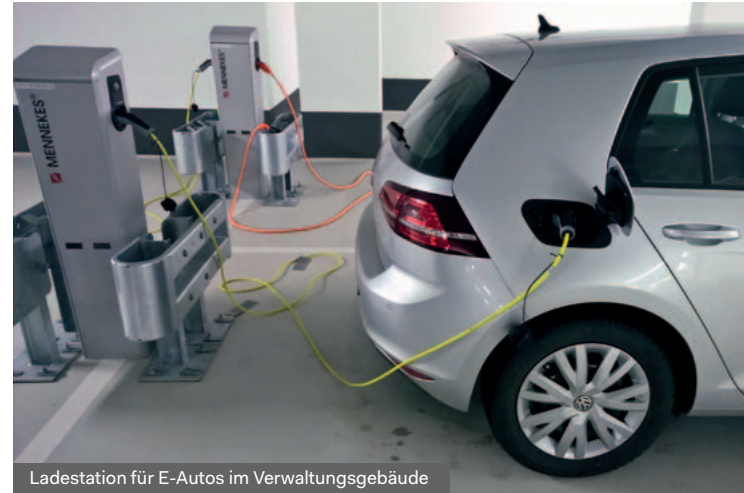
Ladestation für E-Autos im Verwaltungsgebäude
