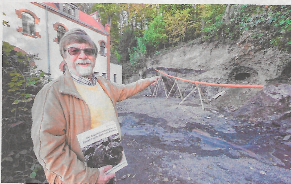
Über den Bergbau in Kupferdreh hat Stadtteilhistoriker Johann Rainer Busch jüngst ein Buch geschrieben, nun steht er an der Kupferdreher Straße, wo der Stollenzugang bei Bauarbeiten freigelegt worden ist.
