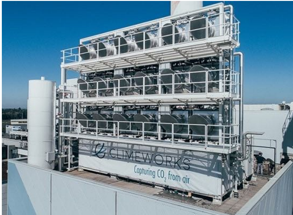
Abb. 4-4 Climeworks DAC-18 Anlage in Hinwil, Schweiz (Abscheideleistung 0,9 kt CO 2 /a)
