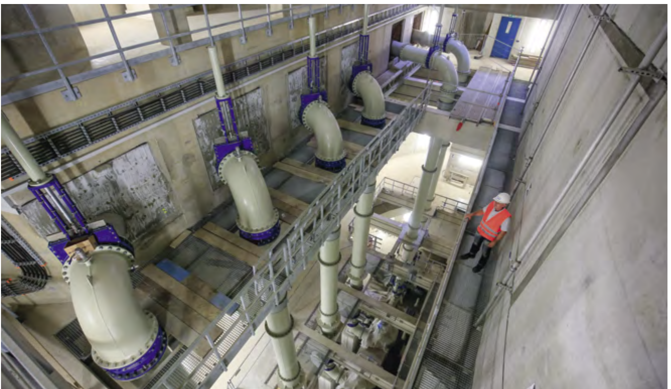
Das im September 2018 in den Betrieb gegangene Pumpwerk Gelsenkirchen ist eines der Herzstücke des international wegweisenden Emscherumbaus.
