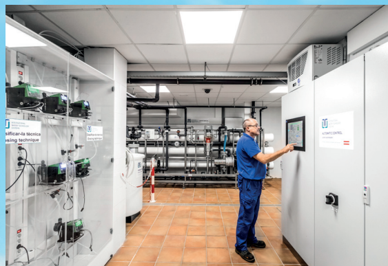
Auf Mallorca betreibt der ROBINSON Club eine Meerwasserentsalzungsanlage – sprudelndes Sodawasser ist das Ergebnis.
