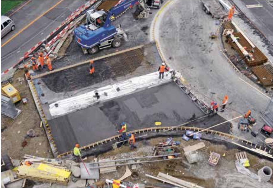
Arbeiten an der ersten Etappe (oben) und an der dritten Etappe (rechts).
