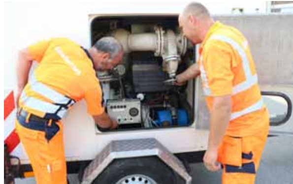
Hochleistungspumpe im Kanalbetrieb.
