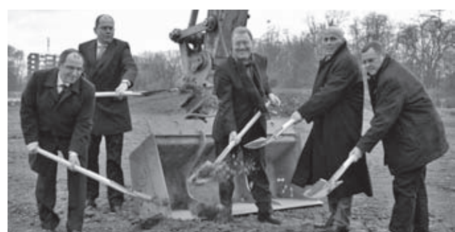
Spatenstich zur Wasserenthärtungsanlage am Wasserwerk In der Elt in Linn (von links): Michael Rögele, Leiter Markt/Betrieb SWK Aqua, Carsten Liedtke, Vorstand SWK, Winfried Schittges, stellv. Aufsichtsratsvorsitzender der SWK, Martin Cirener, Vorstandsvorsitzender SWK sowie Gerd Lübbe, Geschäftsführer der ausführenden Baufirma „Rostek & Pesch“.
