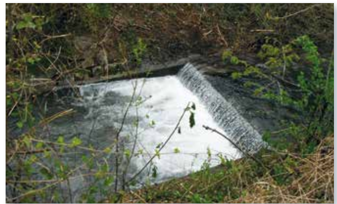
Sohl Absturz am Betriebsleiterhaus vor der Maßnahme
