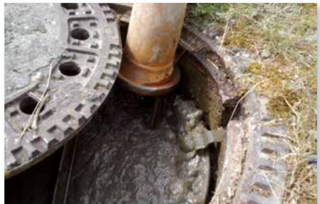
stark verschmutzte Einleitung in den Kanal durch falsche Anschlüsse am Sedimentationscontainer
