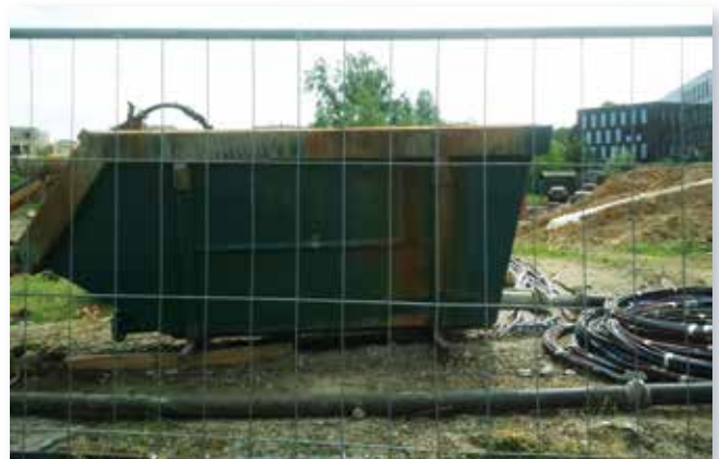
Sedimentationscontainer: Verwechslung bei Anschluss der Zu- und Ablaufleitungen
