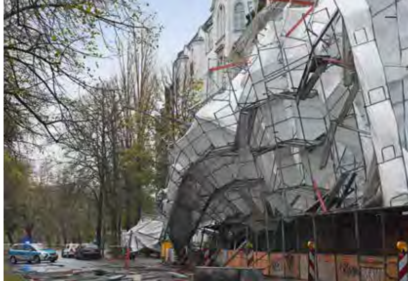
Ein eingestürztes Baugerüst droht Ende Oktober am Schöneberger Ufer in Berlin auf die Straße zu krachen. Orkantief HERWART wütete vor allem im Norden und Nordosten des Bundesgebiets. (Quelle: picture alliance / Paul Zinken / dpa)
