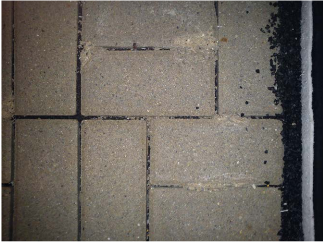
Bild 3.4.16-1 Schollenartige Abblätterungen infolge von Vorsatzbetonschädigungen an den Kanten einzelner Betonpflastersteine
