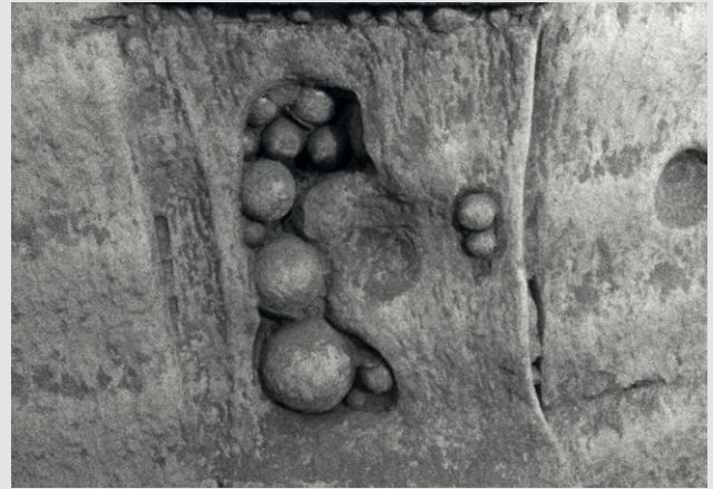
Bild 2.1-1 Schäden an der Panzerung
