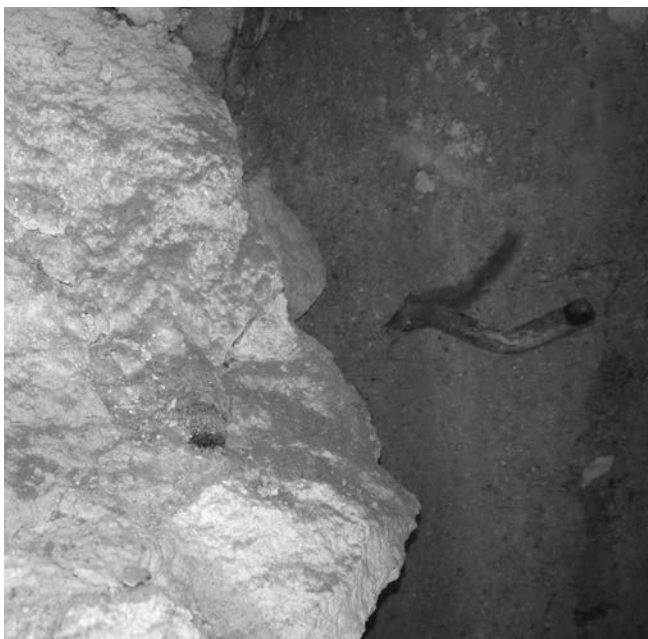
Bild 2.1.2-1 Metallanker im Vorwärmer werden von korrosiven Substanzen angegriffen
