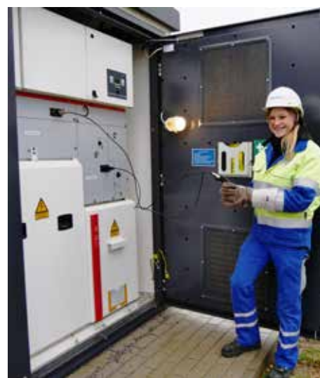
Ausbildung bei Westnetz: Celine Mann bei der Messung an einer Station in Dormagen.
