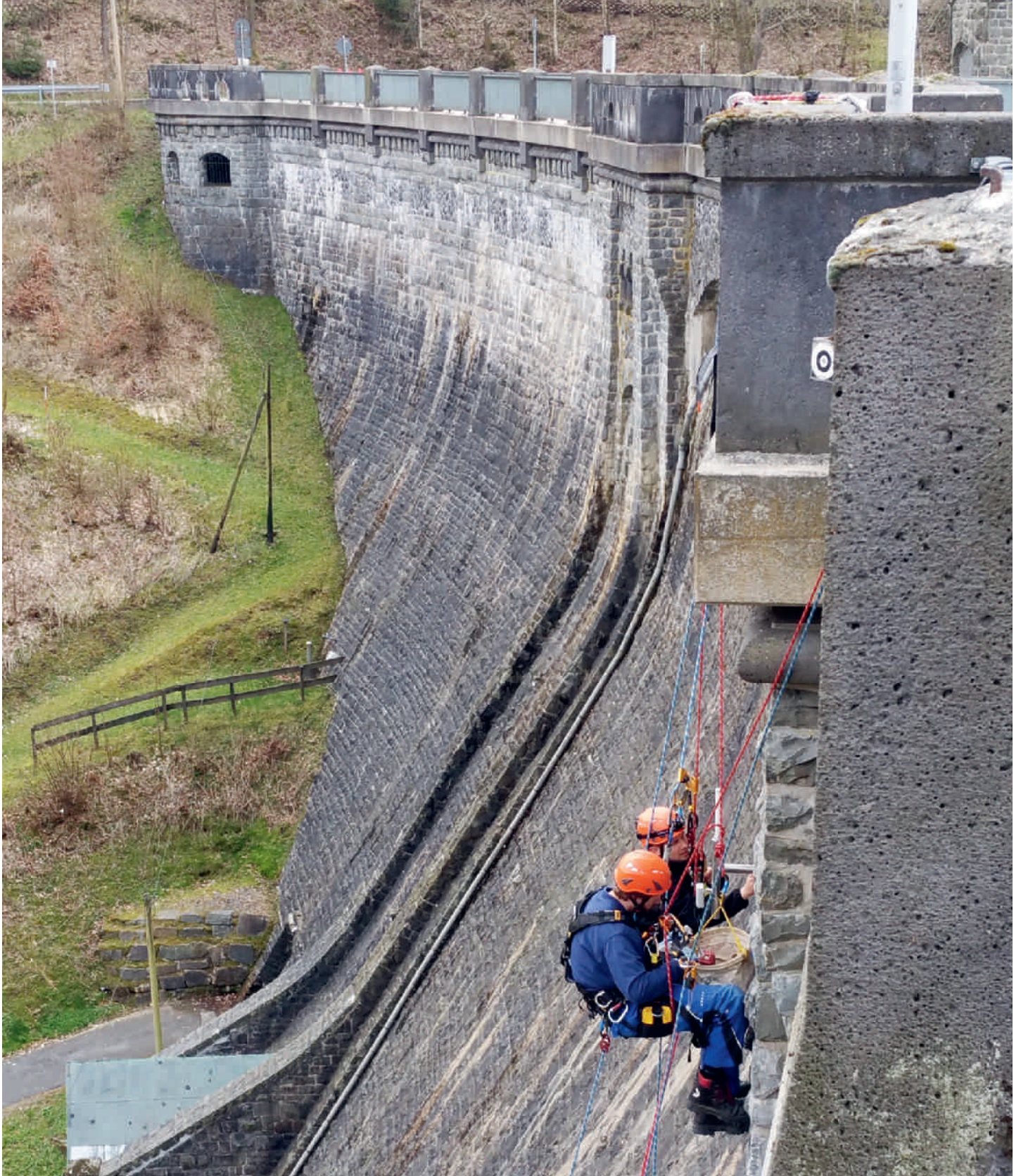
Aufbau einer Richtfunkstrecke an der Fürwiggetalsperre Installation of a radio link at the Fürwigge dam
