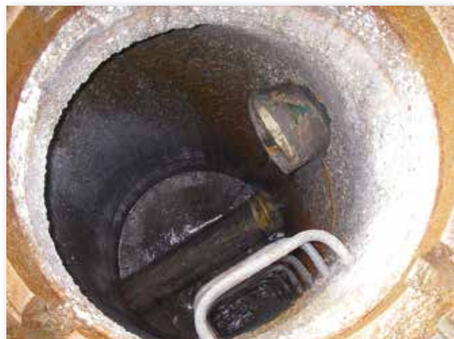
Kanalschacht mit starken Betonkorrosionen
