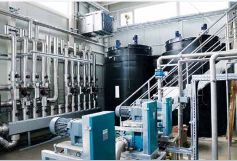
Lagertanks Flockungsmittelanlage KW Monheim
