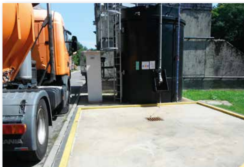
Fällmittelanlage auf dem KW Solingen-Gräfrath
