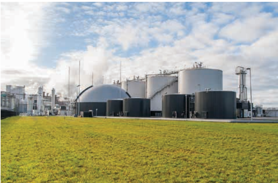
GROSSE BIOMASSEN-VERGÄRUNGSANLAGE IN GRONINGEN
