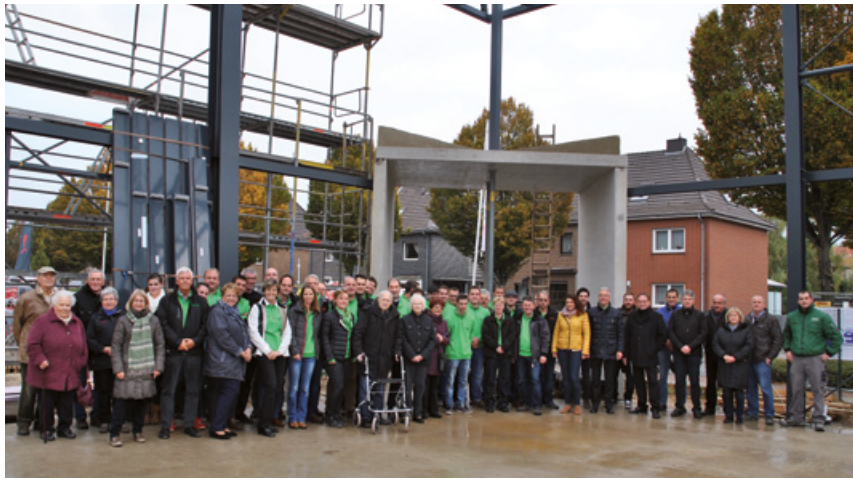
Familie Wachten und die Belegschaft der Firma Wassenberg GmbH feierten gemeinsam mit Handwerkern, Planern und Nachbarn das Richtfest an der Von-Goldammer-Straße.
