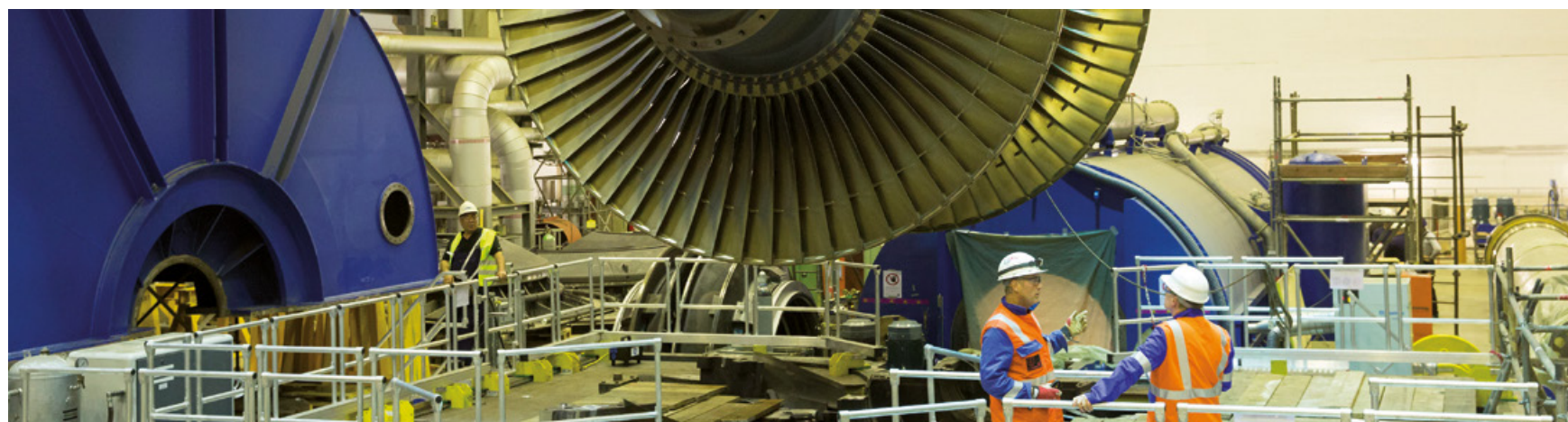
Einhub eines Niederdruck-Turbinenläufers
