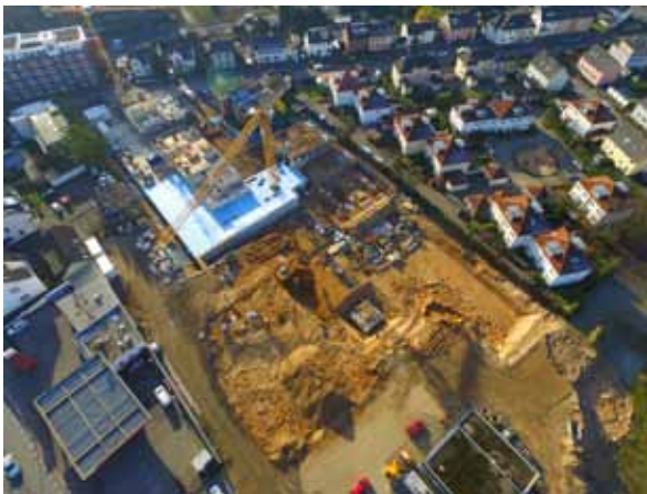
Zu den aktuell größeren Bauprojekten für angemessenen Wohnraum in Langenfeld gehört das Neubaugebiet „Zur alten Feuerwache“ der Firma Paeschke. Foto: Andras Voss
